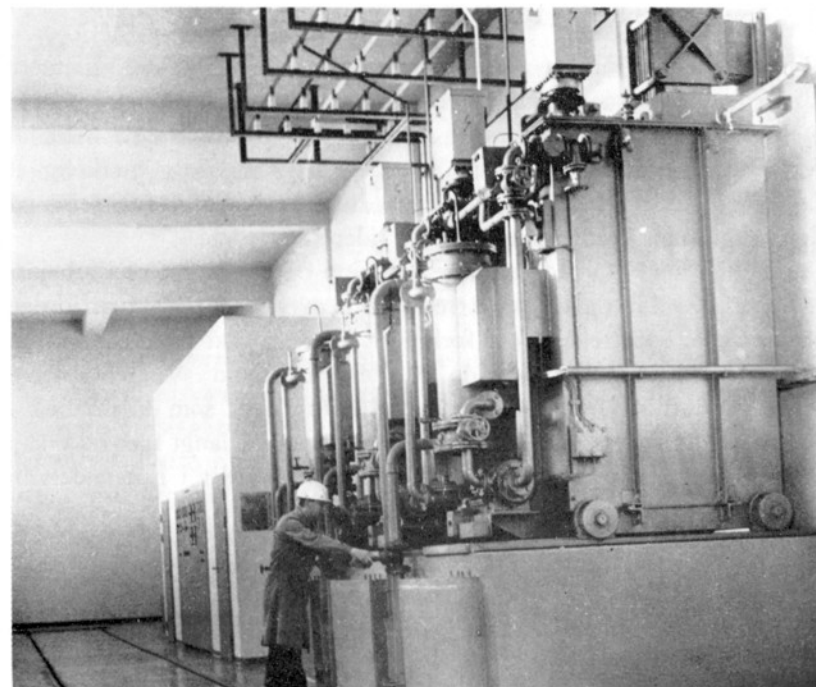
Det fins også „rene“ omgivelser ved bedriften. Her er transformatorrommet for den nyeste ovn.
